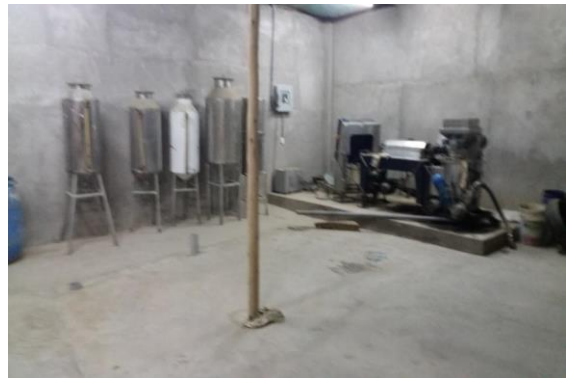
Instalaciones de los equipos de la planta de aceite de olivo de Jaqué.
